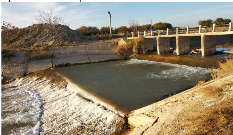
Рис 4. Водозаборное сооружение «Хачкаб» (Гиждуванский район)
